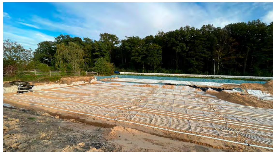
Ausschnitt der Kollektorfläche. Bildquelle: Steinhäuser GmbH & Co. KG
