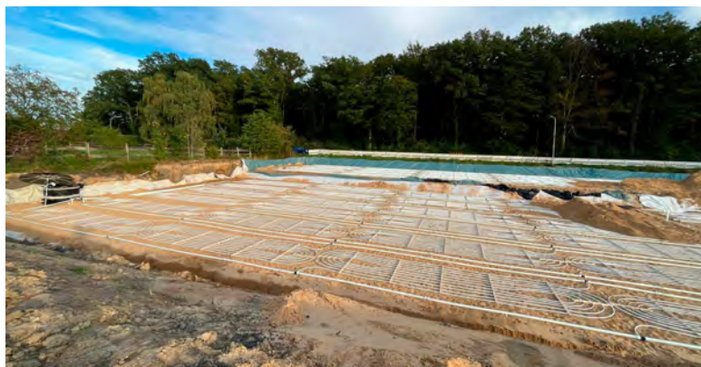
Ausschnitt der Kollektorfläche Bildquelle: Steinhäuser GmbH & Co. KG
