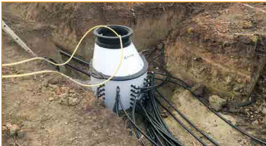
Verteilerschacht als Zusammenführung bei Erdwärmeprojekten.
